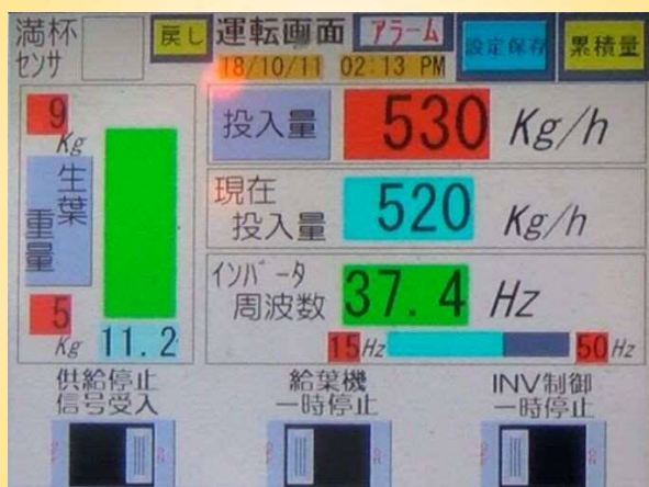
タッチパネル式制御盤
